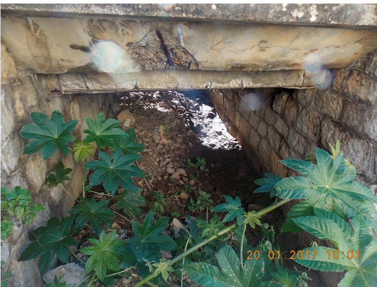
Fig. 5.2: Scatolare n.2 presente lungo la via dell'Ulivo. (1,20 m altezza x 2,00m larghezza)
